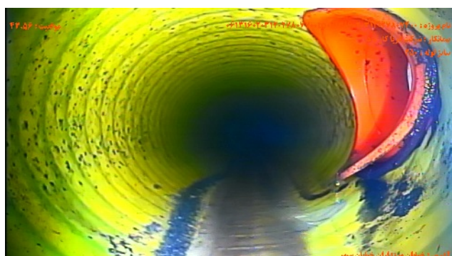
شماره تصویر ۵ عنوان موقعیت ۴۳.۵۶ کد اتصال جانبی معيوب / اتصال معيوب انشعاب
