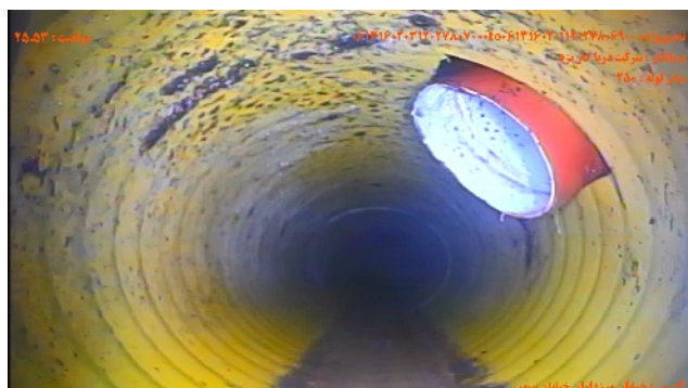
شماره تصویر ۵ عنوان اتصال جانبی معیوب / انشعاب مهاجم- نفوذ به داخل لوله موقعیت ۲۵۰۵۳ کد CXI درصد ۱۰
